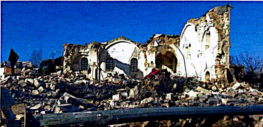
Adıyaman'da 14. yüzyılda yapılan Ulu Cami de depremde büyük hasar gördü.
